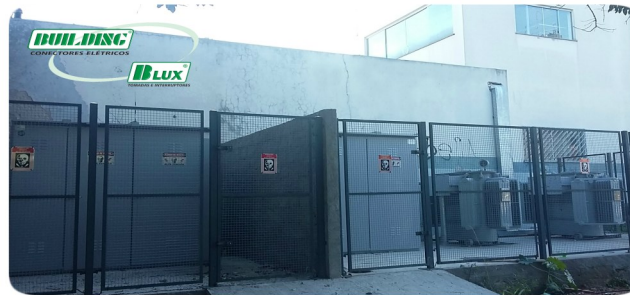
Cabine Primária: Cabine de Entrada (à esquerda), Cabine de Distribuição (no meio), 2 Transformadores (à direita)
